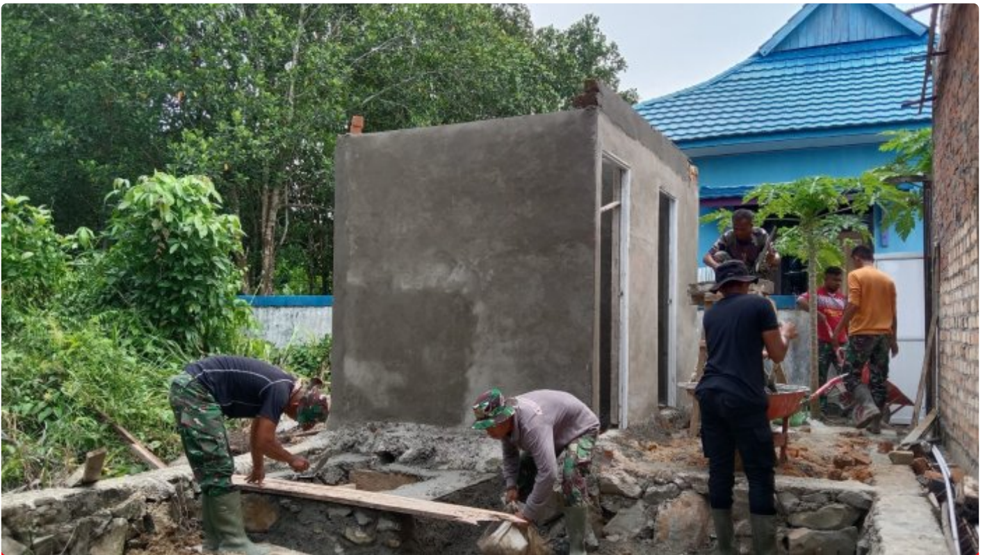
Satgas TMMD ke- 118 Wiltas Kodim 0910/Malinau Progres Pembuatan Septic tank MCK Gereja
